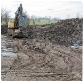
Auf einem halben Hektar wurde der Schlamm beräumt und eine Wasserfläche als Sedimentfang geschaffen
